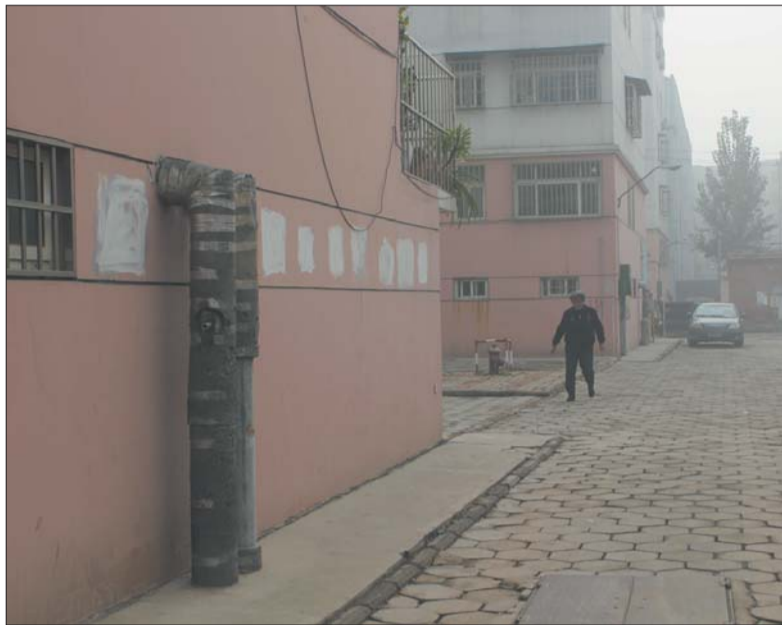
在阳光木材组团小区，这两根粗管子就是中央空调的供热管道。本报记者 杨淑君 张召旭 摄
