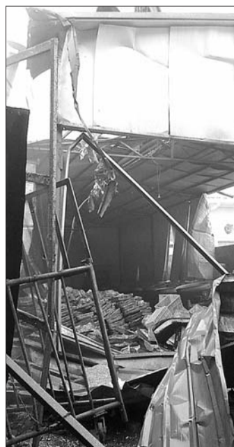
▲爆炸过后,加工车间倒塌。见习记者 王茂林 摄
