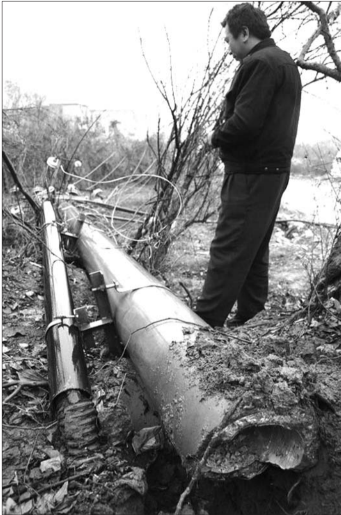
家里没电,居民看着倒下的电线杆没办法。记者 赵兴起 摄
