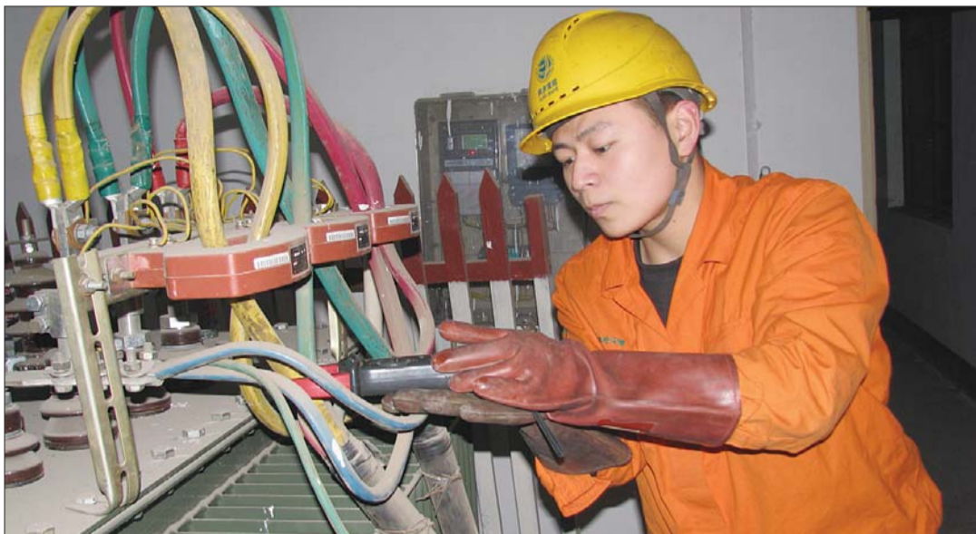
抢修工人对变压器进行检测。本报记者 王颜 摄
