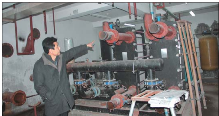
小区泵房内未完工的管道。记者 王晓霜 摄
