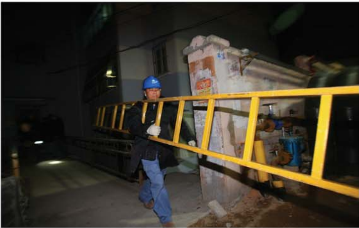
14日晚,承德路2号一栋居民楼断电,抢修人员赶赴现场。
