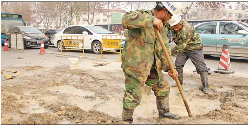
的水坑。▲抢修人员正在清理路面下陷而形成的水坑。记者 寇润涛 摄
