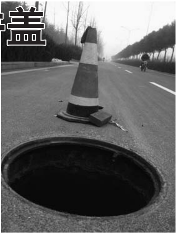
丢失了井盖的检查井。
