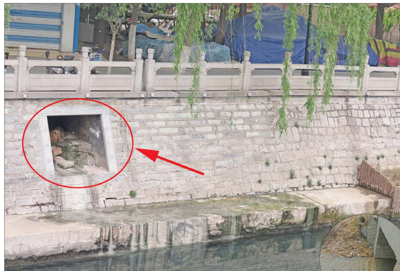
▲东护城河东门桥边,一处雨水方沟正在往外淌污水。 ▶西折腰村旁的刘公河,隔三岔五河水就变红变绿,味道刺鼻。
