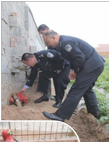
嫌疑人在这条管道上打孔,埋下皮管。
