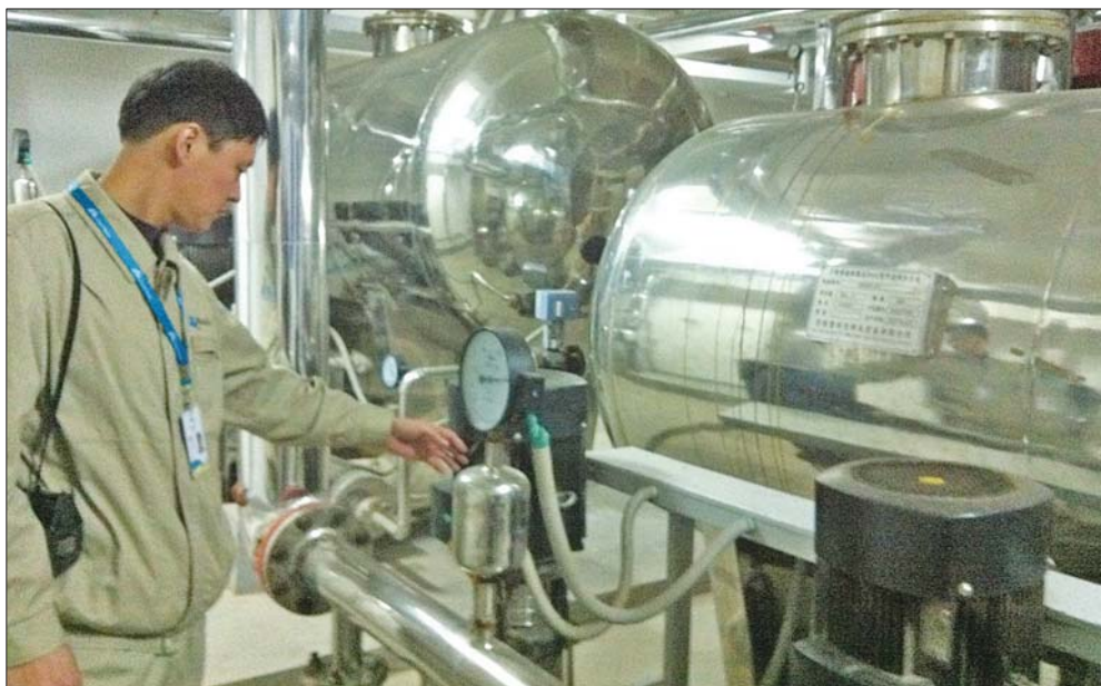
运行情况(资料片) 喻雯 摄 工作人员在检查二次供水设施
