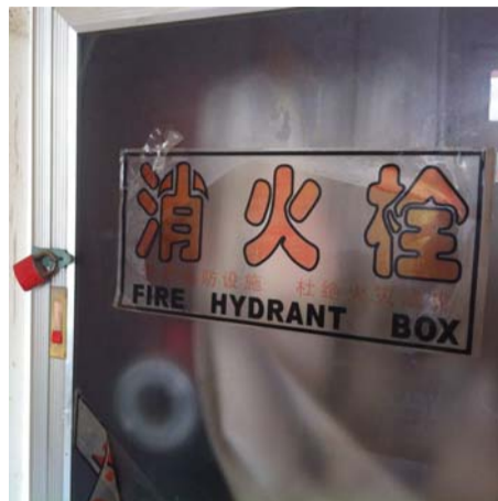
消防栓被物业锁上。
