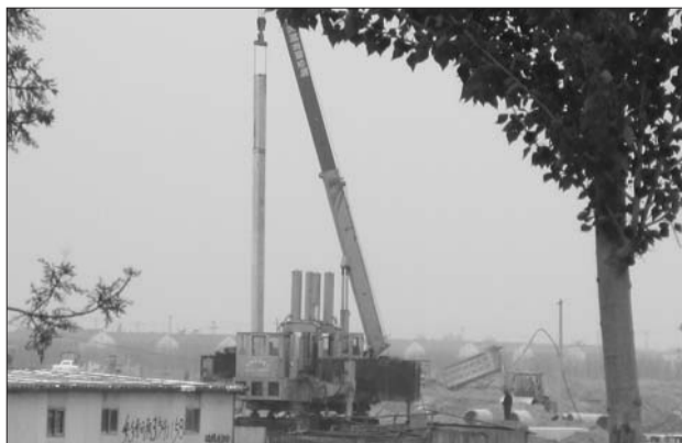
4月20日记者在滨州无棣齐星产业园看到,打桩机正在将空心方桩打进地下。记者 李岩侠 摄
