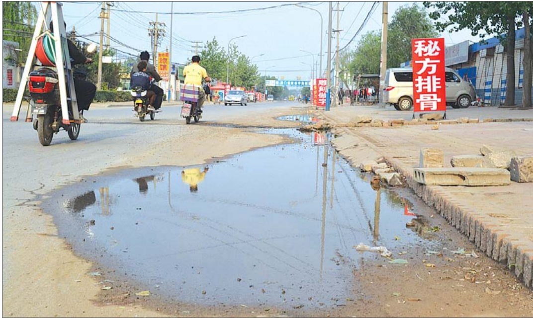
栗山路污水井外溢污水占据了部分路面。本报记者 赵伟 实习生 李杨伟 摄
