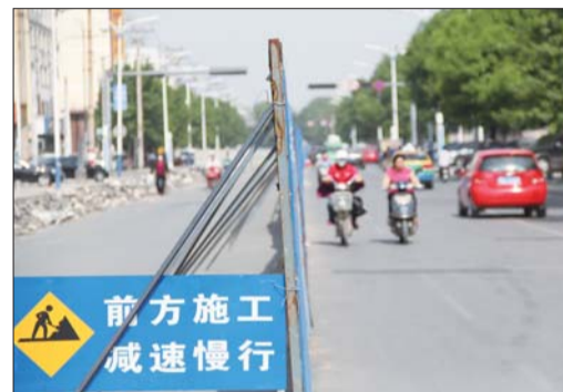
黄河六路渤海六路到渤海七路路段,警示牌上提醒市民减速慢行。 记者 孙珊 摄
