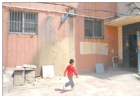
粉尘从排空管道放到空气中。 本报记者 王瑞景 摄
