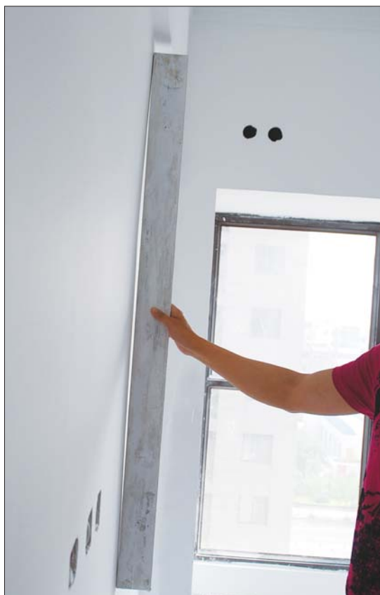
肖先生用长尺量一下墙壁,尺子与墙壁之间有一条明显的缝隙。记者 李运恒 摄
