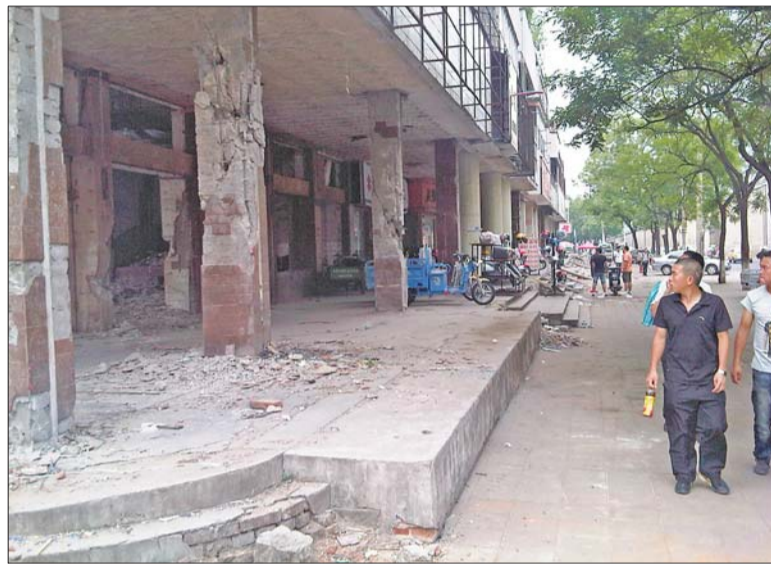
几位行人从破裂的楼柱附近经过。 本报记者 任志方 摄
