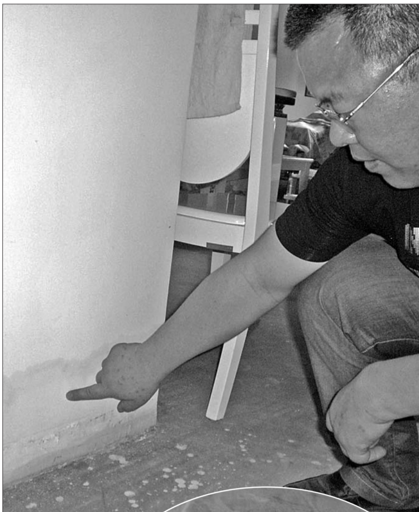
▲墙壁上留有被水浸泡过的痕迹。 韩伟杰 摄
