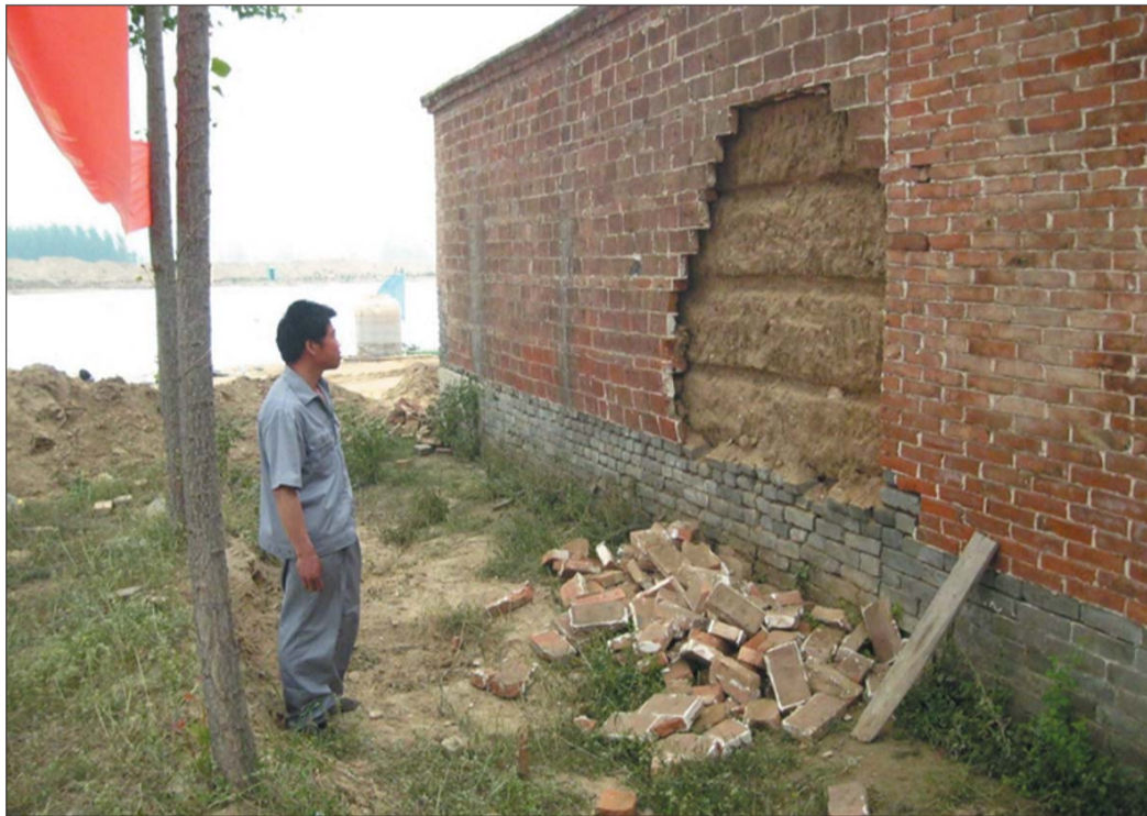
外墙皮脱落的房屋,它旁边就是工地。本报记者 焦守广 摄。
