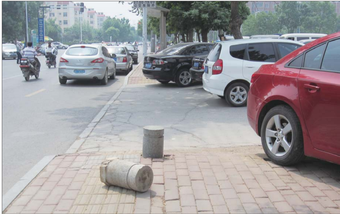
滨州市区内去年刚刚安装的一千个挡车石,近一年的时间竟被人为破坏近500个,为此修补被损坏的设施就需要近十万元。图为渤八黄八附近人行道上的一处挡车石被损坏后,许多车辆停在了人行道上。
