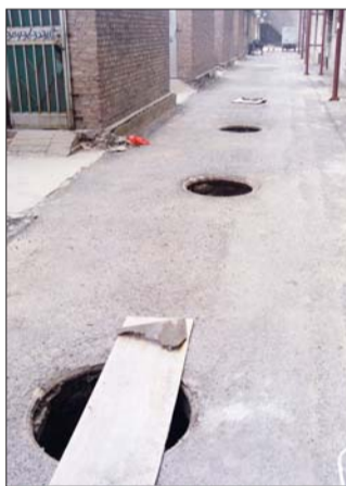
宿舍区内丢了井盖的下水道井口只好用木板挡着。 记者 张爽 摄
