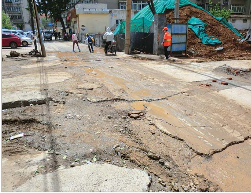
棋盘小区内的东舍坊街破损严重,居民出行很不方便。
