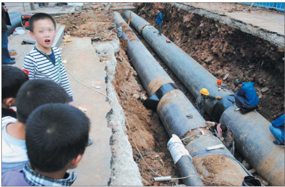
沟边玩耍的孩子指出塌方地点。本报记者 吕修全 摄
