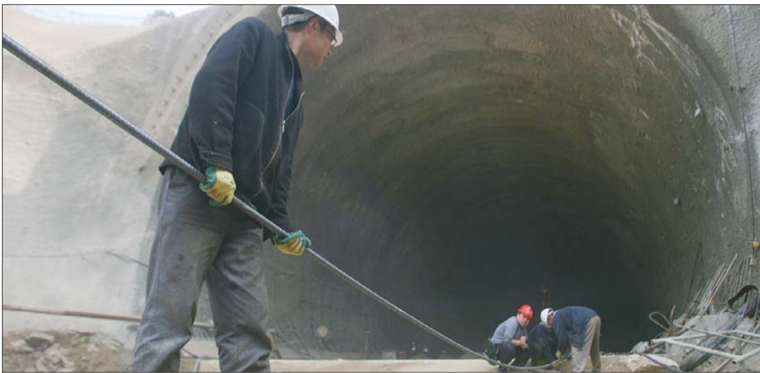
车山隧道外,工作人员正将钢筋拧开后抬进隧道做底板焊接。本报记者 赵金阳 摄
