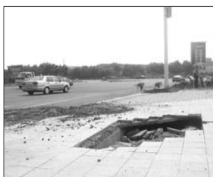
桥面人行道损坏严重。 本报见习记者 韩德勋 摄
