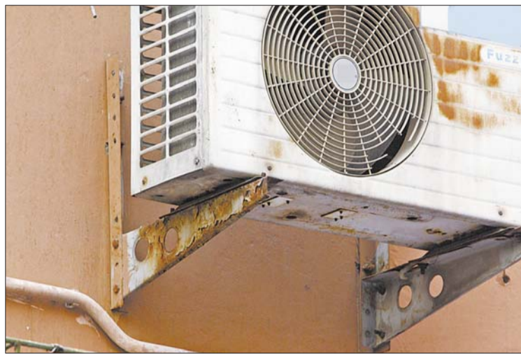
一个空调室外机的支架锈迹斑斑。(图片由市消保委提供)
