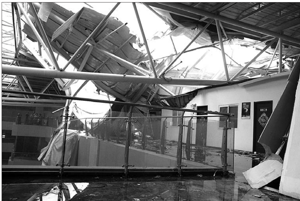
客运中心顶棚裂口长约18米、宽约15米。
