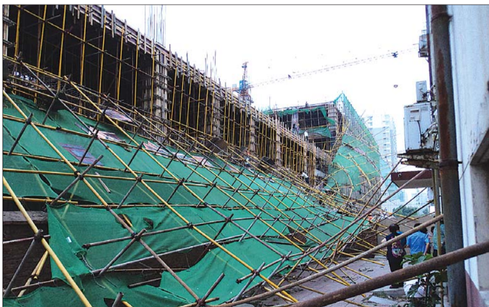
▲防护网的铁架子砸到三楼后顺势倒在地上。(图片均由小区居民提供)
