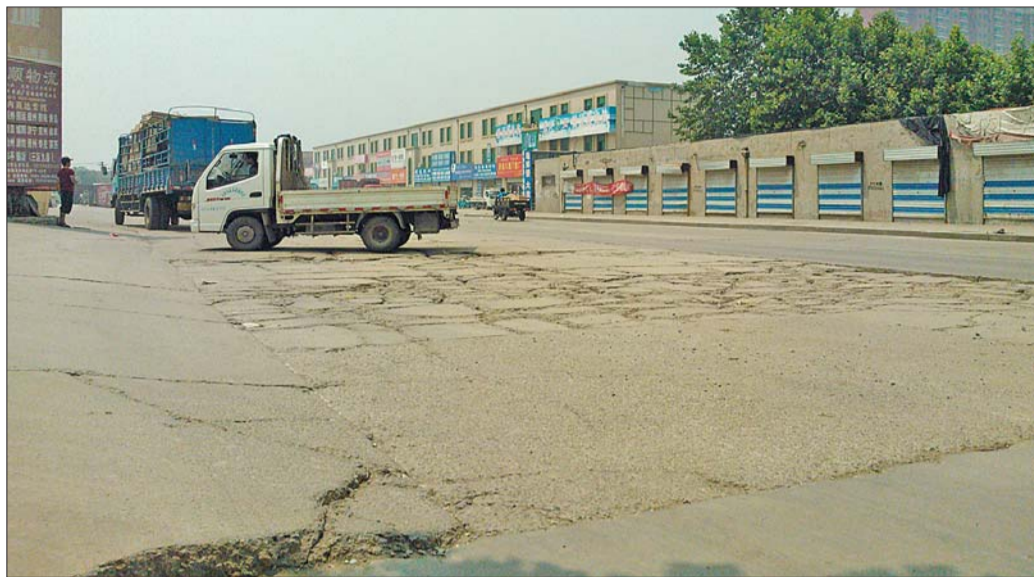
舜馨路部分水泥路面支离破碎。 记者 任志方 摄
