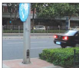
▲解放路一路灯盒盖缺失。见习记者 张泰来 摄
