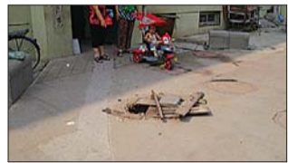
井盖缺失,孩子就在不远处 拍摄地点:济南市长清区大学路乐天小区2区3号楼4单元门口 拍摄时间:6月20日 拍摄人:济南读者邵先生
