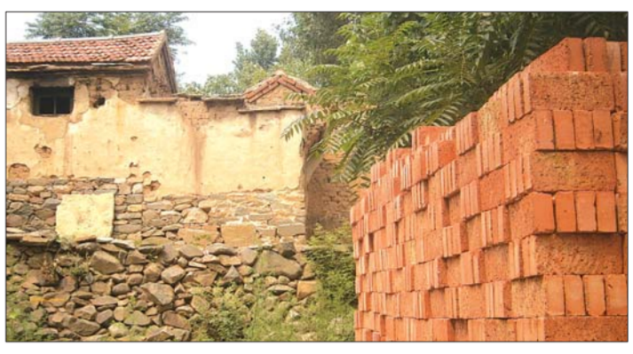
▲旧房太破,新砖买好,愣是不敢盖新房。
