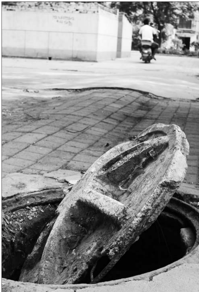
老旧小区的基础设施维护管理急待“管家”。
