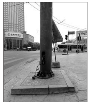
拍摄地点：经七纬二交叉口东北角 拍摄时间：6月22日 拍摄人：济南热心读者杨先生 说明：一根路灯杆线盒缺失，一根电线伸出杆外。
