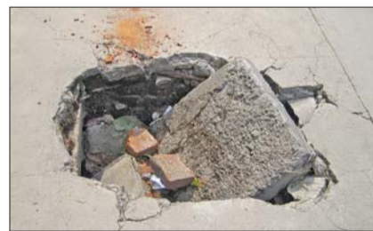
拍摄地点:花园小区三区10号楼北侧路中央 拍摄时间:6月24日 拍摄人:济南热心读者 说明:化粪池缺失井盖。
