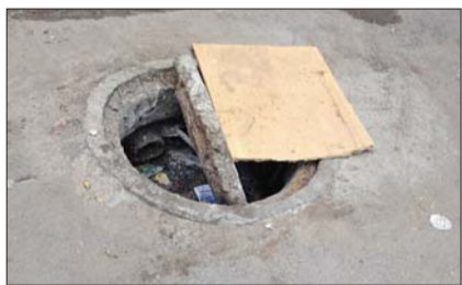
▲拍摄地点:天桥区南刘家庄13号楼 拍摄时间:6月23日 拍摄人:济南热心读者 说明:污水井盖破损。
