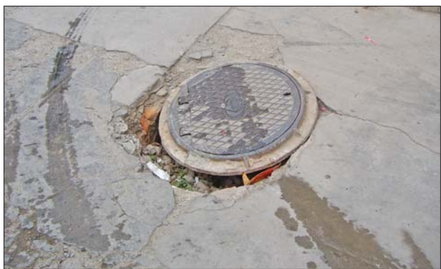
▲拍摄地址:长清区水鸣街港基二区6号楼大门口 拍摄时间:6月25日 拍摄人:热心读者孟民 说明:井口已经毁坏近一个月了。
