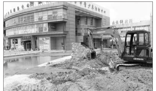
管线破裂后,路面被水淹没。本报记者 嵇磊 段学虎 摄
