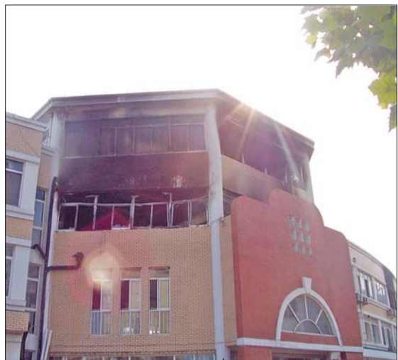
发生火灾的楼层很多窗户烧成了“黑洞”。
