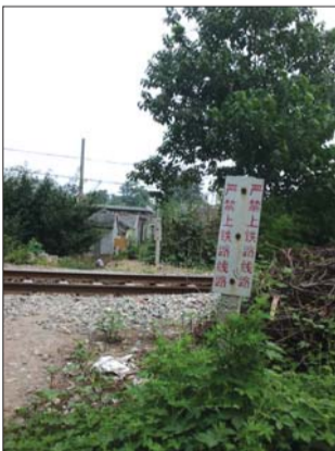
前省庄村铁道口周围缺少防护措施。
