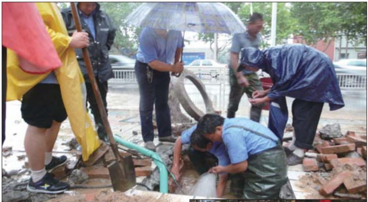
▲自来水管抢修人员冒雨紧急作业。 ▶事发点喷出1米高水柱, 汩汩清水白白流入路面上的下水道。
