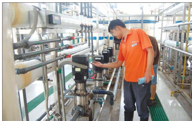
工作人员检查垃圾渗滤液无害化处理装置。
