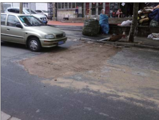
长山路的路面塌陷处已被填平。 陈之焕 摄
