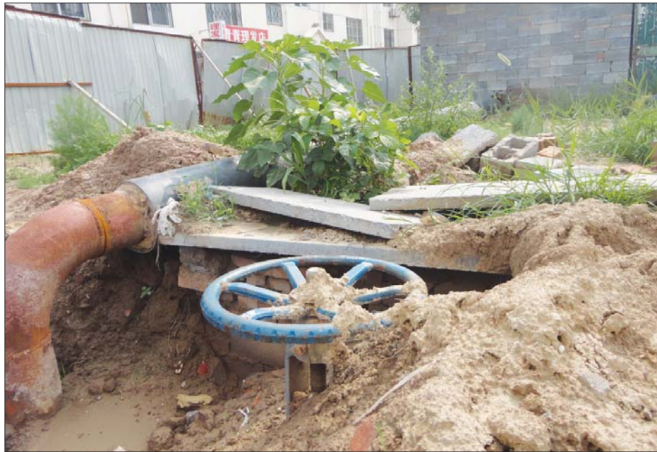
已经停工的换热站。本报记者 侯晓 摄
