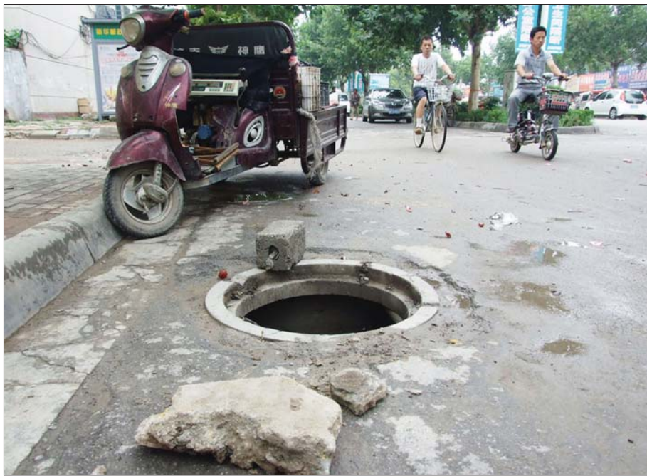
医北胡同附近的卫育路西侧路面上的一处井盖缺失,成为潜在危险。 本报记者 李璇 摄
