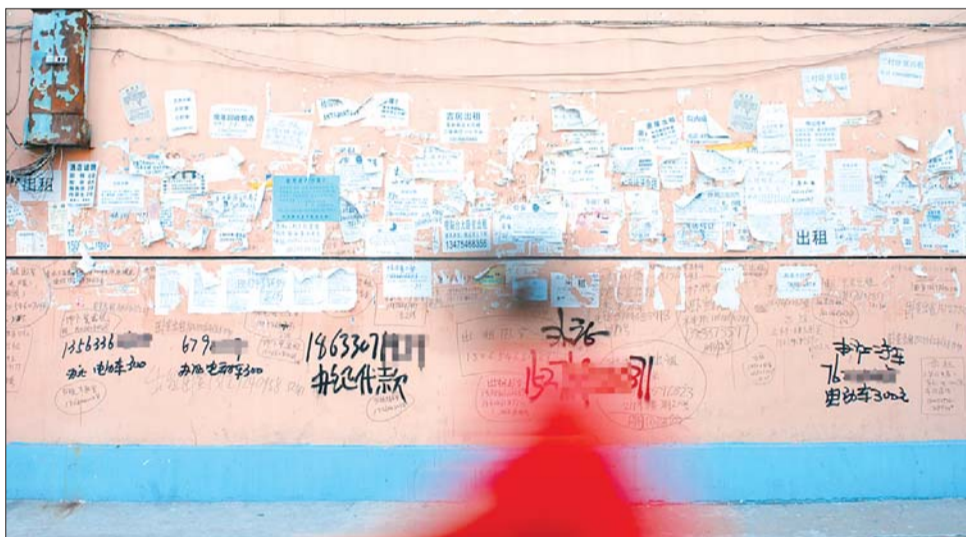
运河路一小区楼体外墙上张贴涂画着各种小广告。
