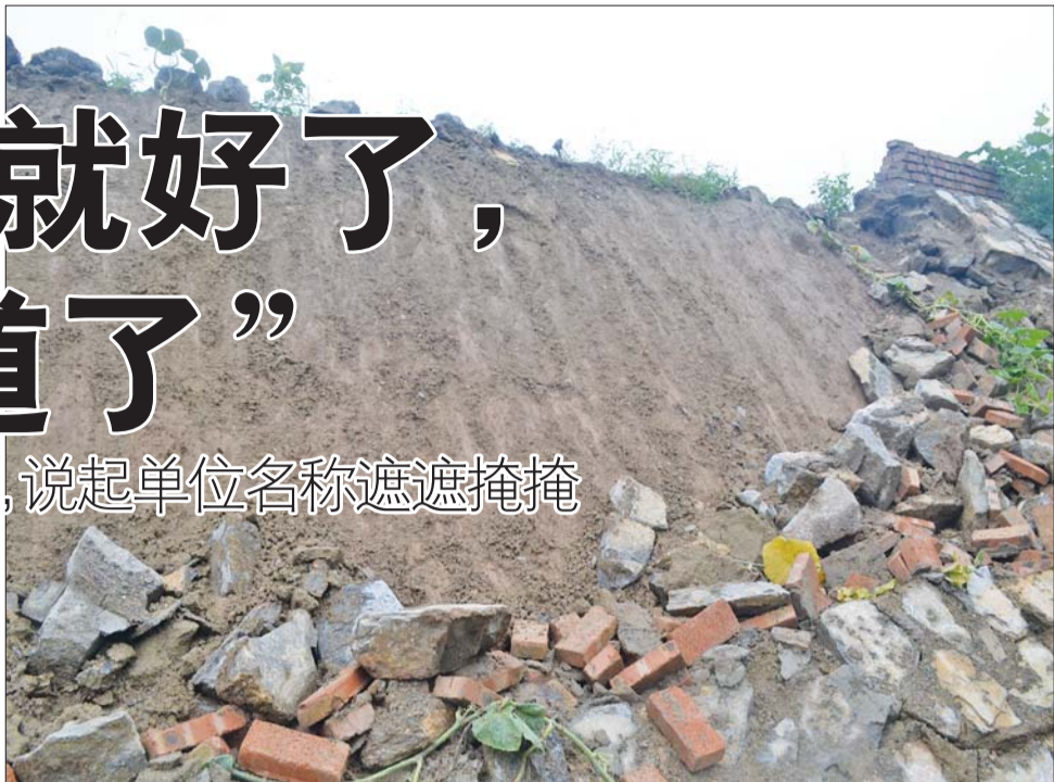
泄洪沟东侧塌陷处露出大片泥土。 本报记者 赵伟 摄
