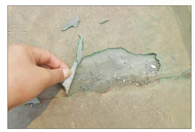
▲楼顶漏雨,治标没有治本。
