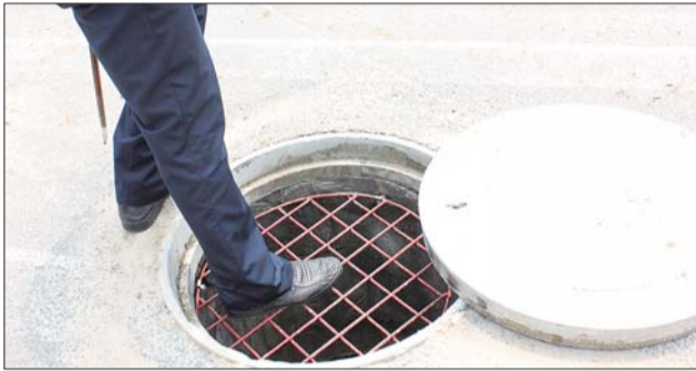
雨水井盖中加装了安全网。本报记者 李玉涛 摄
