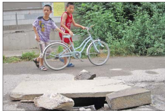
黑洞已被人用石板盖住,但井盖还没换上。本报记者 尹明亮 摄
